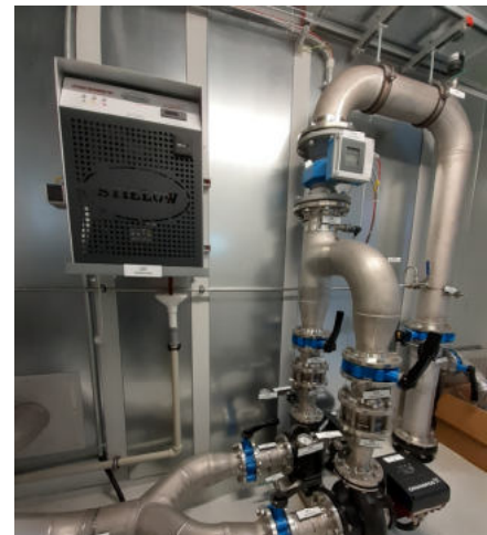
Druckerhöhung und Raumluftentfeuchtung
